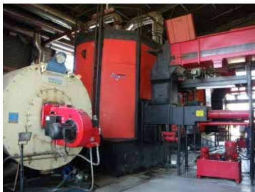
Chaufferie de Corté
